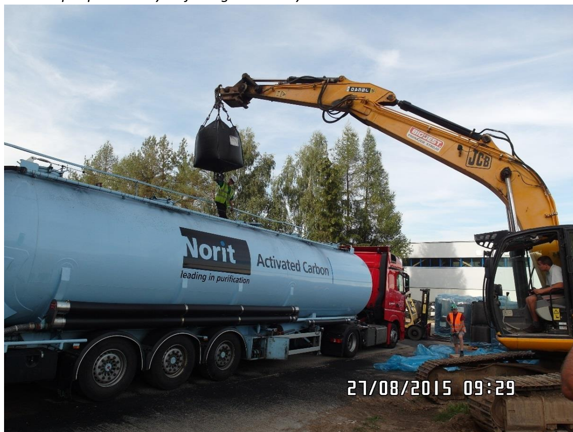
Cisterna pro plnění nových filtrů granulovaným aktivním uhlím
