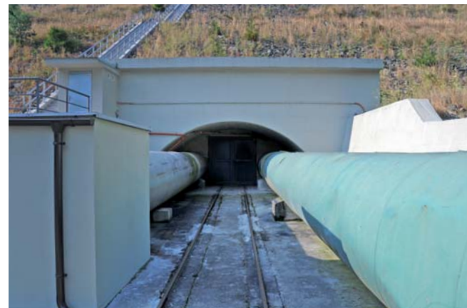
Potrubí o průměru 1200 milimetrů přivádí surovou vodu.
