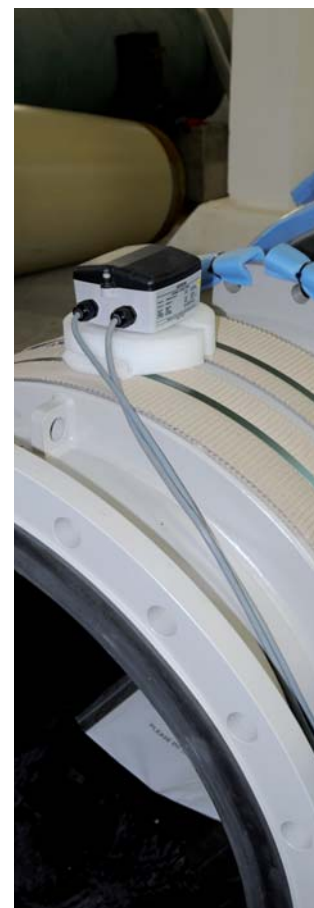
Indukční průtokoměr Siemens DN 800.
