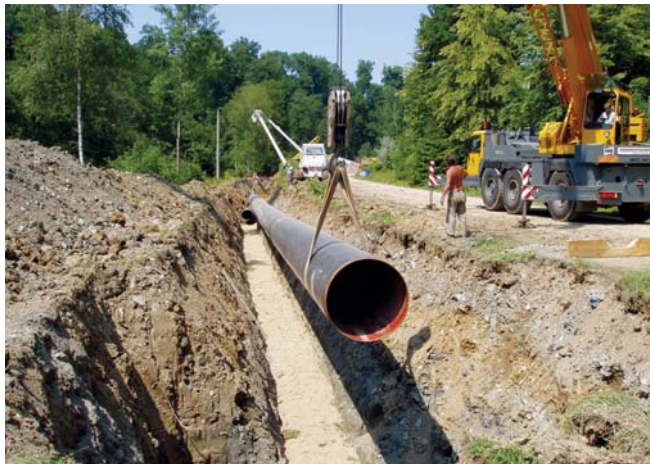
Rezervní přívod z nádrže Římov na ÚV Plav
