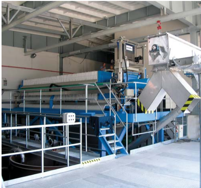
Úpravna vody Plav (kalové hospodářství)
