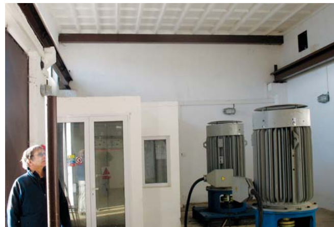
Vidov vnitřek (nová čerpadla)
