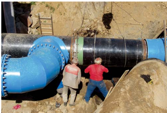
Rezervní přívod z nádrže Římov na ÚV Plav (zdvojení potrubí)
