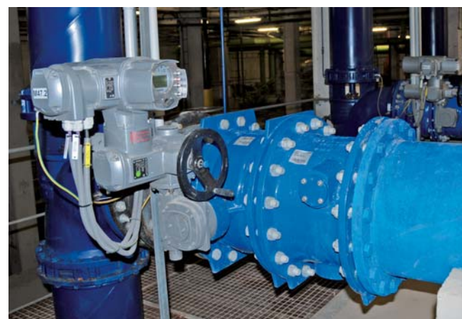
Výtlačné potrubí nových pracích čerpadel.
