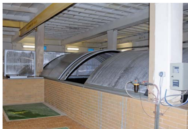
Vlhkost v objektu snížilo mobilní zastřešení nádrží.
