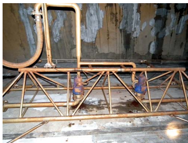
Odsávací zařízení usazovacích nádrží.
