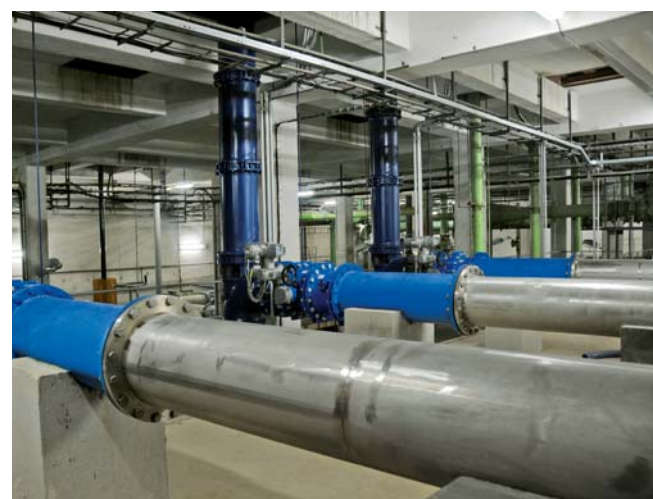
Výtlačné potrubí nových pracích čerpadel.
