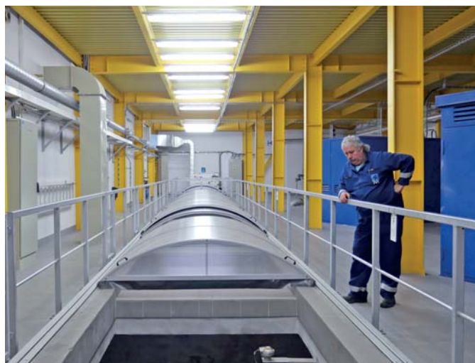
Třetí stupeň úpravy vody – 5 filtrů naplněných granulovaným aktivním uhlím s výškou náplně 205 cm.
