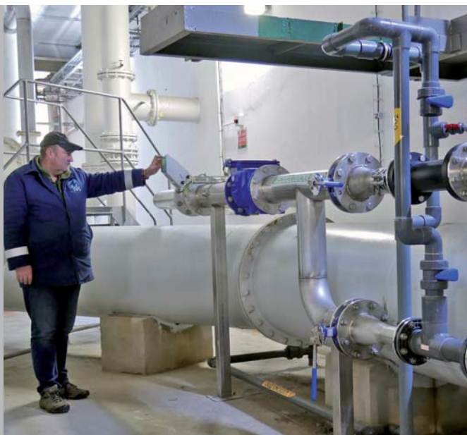
Úprava tvrdosti pitné vody – dávkování plynného oxidu uhličitého.
