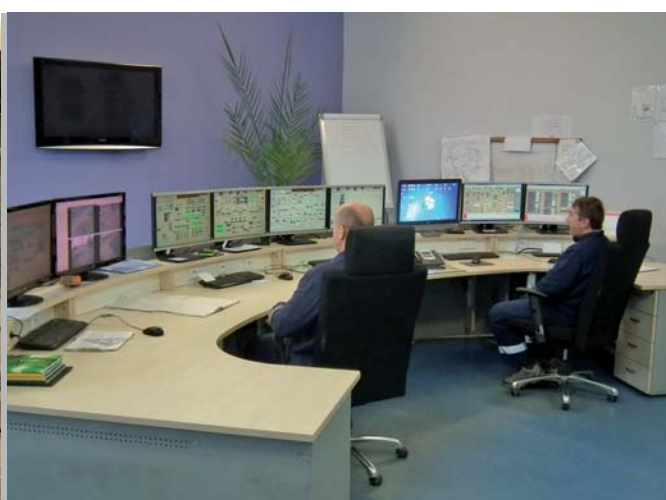
Pracoviště centrálního velínu úpravy a vodárenské soustavy.
