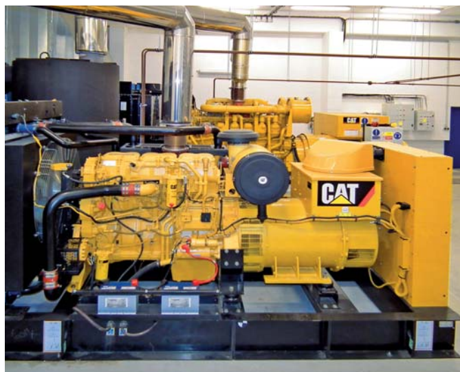
Náhradní zdroje elektrické energie o výkonu 1800 kW pro zajištění provozu úpravní v případě výpadku dodávek elektrické energie.
