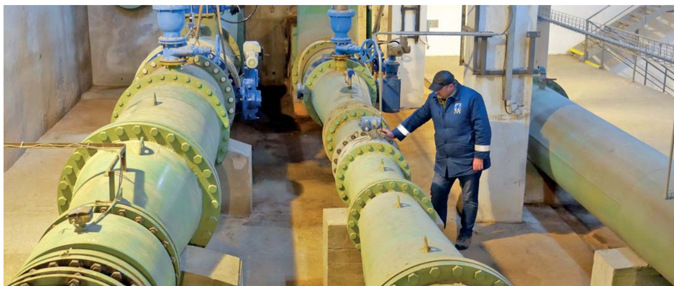
Čerpací stanice – výtlačné potrubí směr České Budějovice a Tábor.
