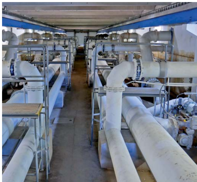
Trubní vystrojení pískových filtrů – druhý stupeň úpravy vody.
