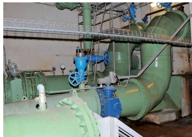
Těmito rourami opouští pitná voda úpravnu a míří do celého kraje.
